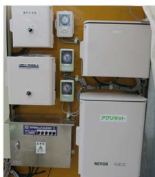
統合環境制御盤
